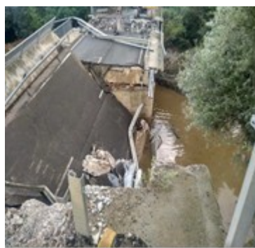
5.IX – разрушен мост на пътя Царево–Ахтопол (снимка: Община Царево)
